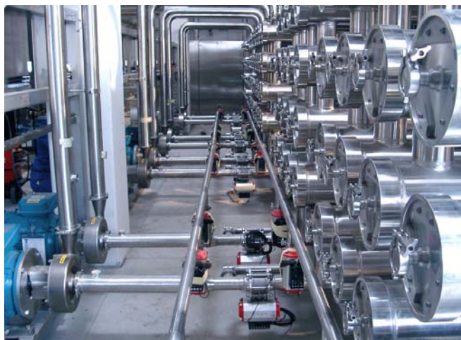
Sistema de 200.000 l/h de capacidad
